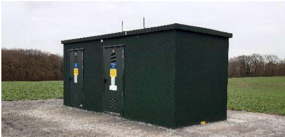
Photo 11. Poste de livraison – source VALOREM
