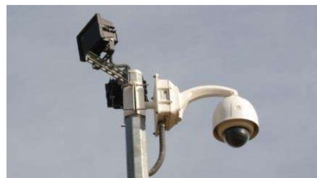
Exemple d'un poteau portant une caméra de surveillance ECOTER, 2013
