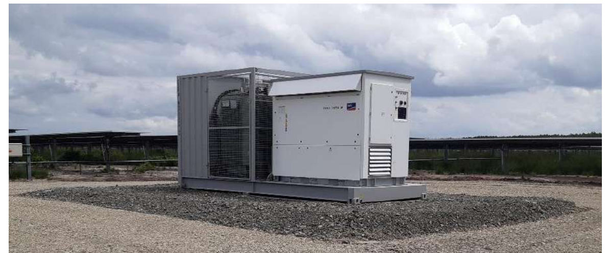
Photo 10. Poste de transformation « outdoor »
